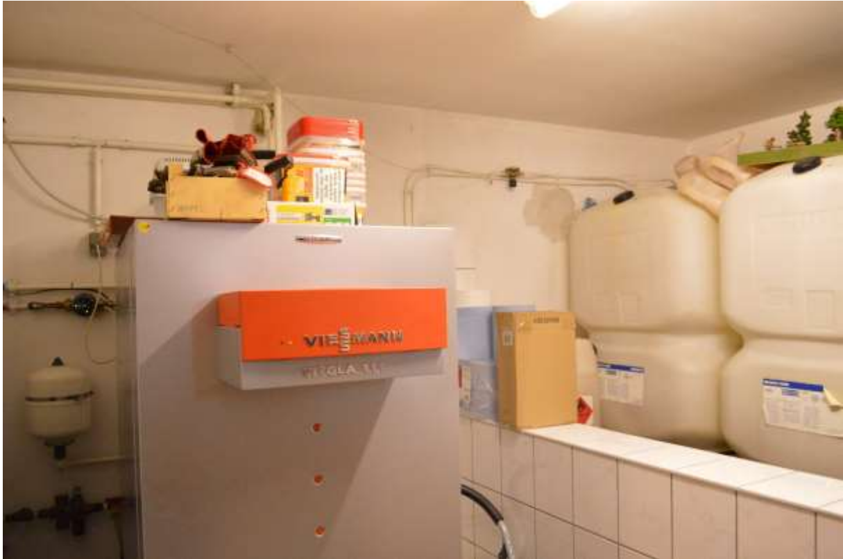
Blick zur Ölheizung
