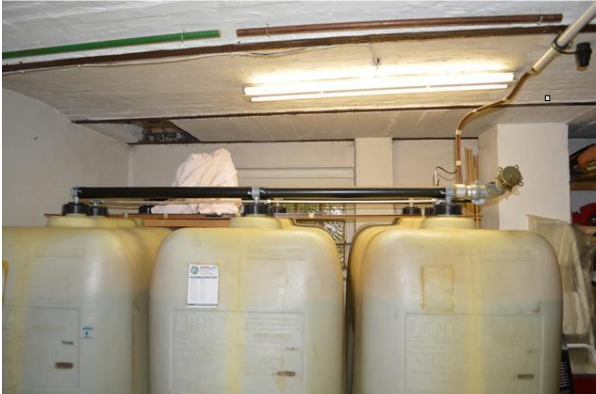
Heizung mit Öltanks im EG
